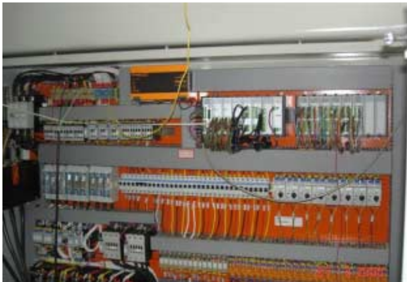
Figura 4.8 - Vista do painel elétrico com o CP à direita.
